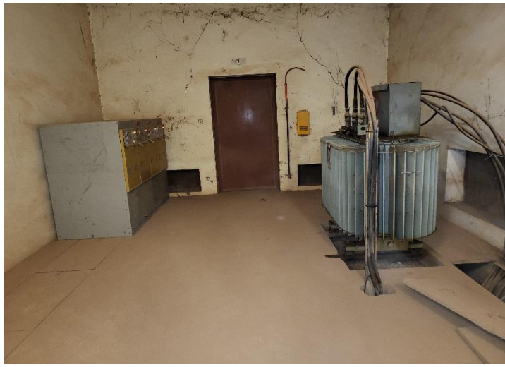
Transformateur MT de l'arrivée du réseau NIGELEC (Société Nigérienne d'électricité)
